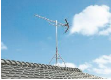
【A-2】 屋根付アンテナ 1本パターン
